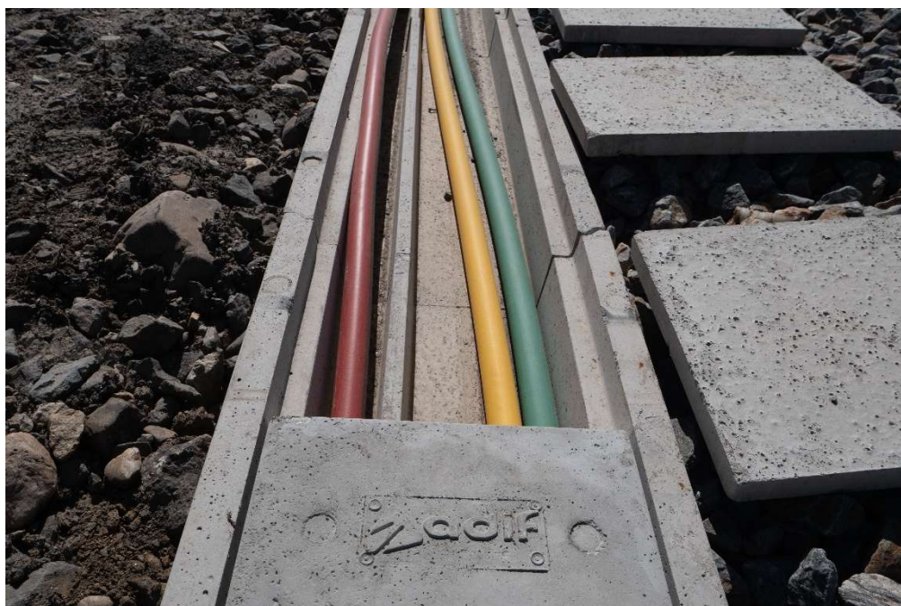
Cables y fibra.
